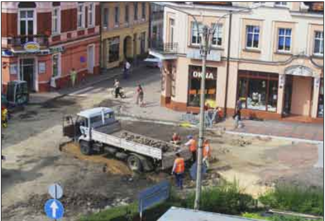
Pierwszy etap przebudowy Rynku. Prace wykonuje Zakład Remontowo – Budowlany Marian Walczak oraz firma PUH Wadri Zuzanna Wawrzyniak.
