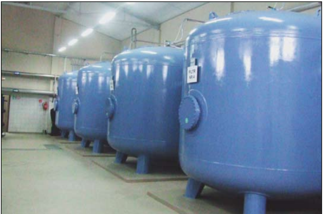
Wyposażenie Stacji Uzdatniania Wody.
